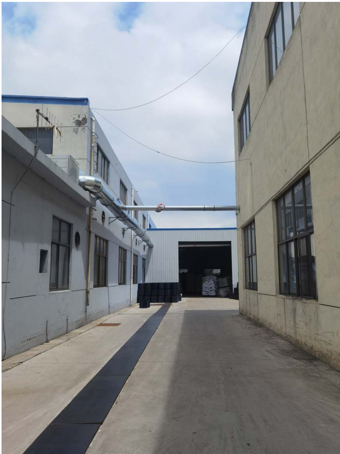
图 1-3 排气筒 DA001 相关车间收集管线
