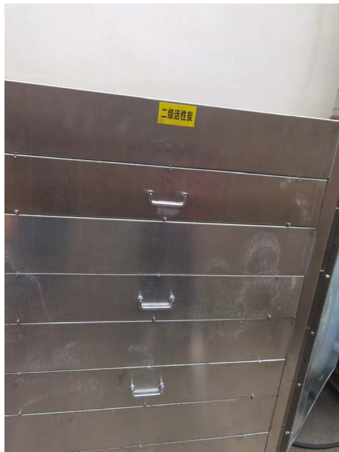
图 2-2 排气筒 DA002 配套的活性炭吸附装置
